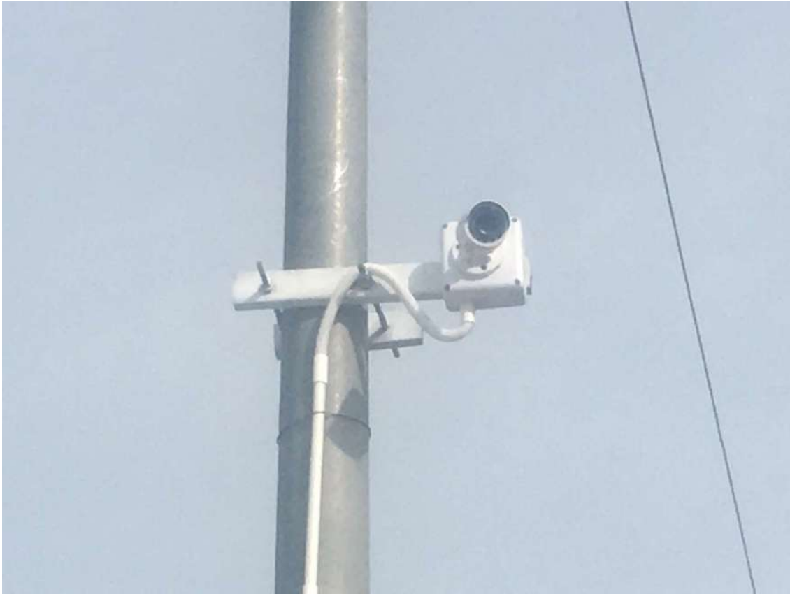
รูปที่ 5.176 การติดตั้งกล้องวงจรปิด (CCTV)
