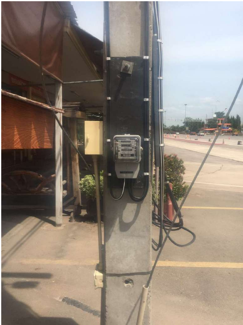
รูปที่ 5.178 การเชื่อมต่อระบบไฟฟ้าแปลงตรวจวัดโครงสร้างถนนลาดยาง
