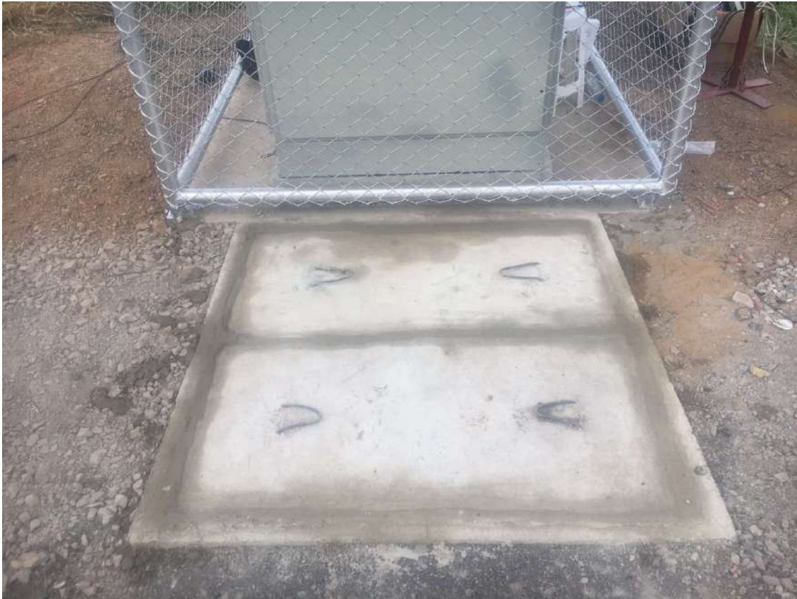
รูปที่ 5.173 บ่อพักสายสัญญาณ
