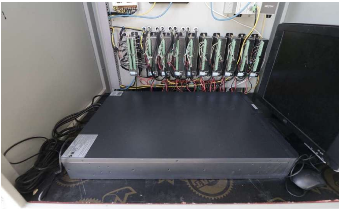
รูปที่ 5.181 อุปกรณ์ UPS สำหรับแปลงตรวจวัดโครงสร้างถนนลาดยาง
